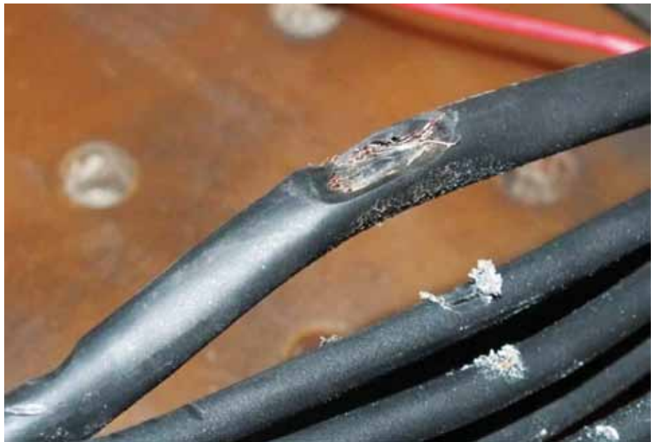
▲ Abb. 2: Resultat einer lockeren Schraube am Kabelbaum: Angescheuerte Zuleitung zum Prüfaufbau.
